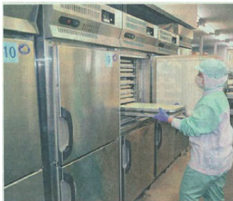
庫内に温度センサーが取り付けられた急速冷凍庫—富山市西宮
